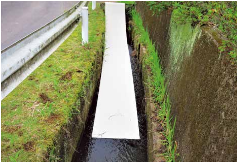
側溝での流出油に吸着対応
